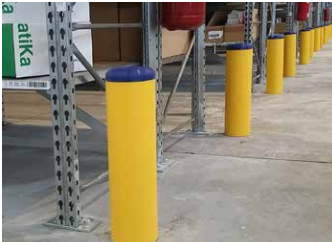
Bolardos para la protección de estanterías y puertas
